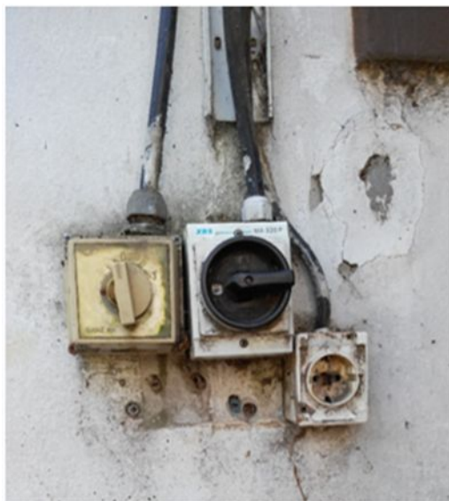
Sérült, nem megfelelő védettségű dugaszolóaljzat, kültéren
