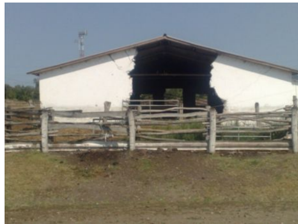
Szarvasmarha istálló nem megfelelő szilárdságú falszerkezete
