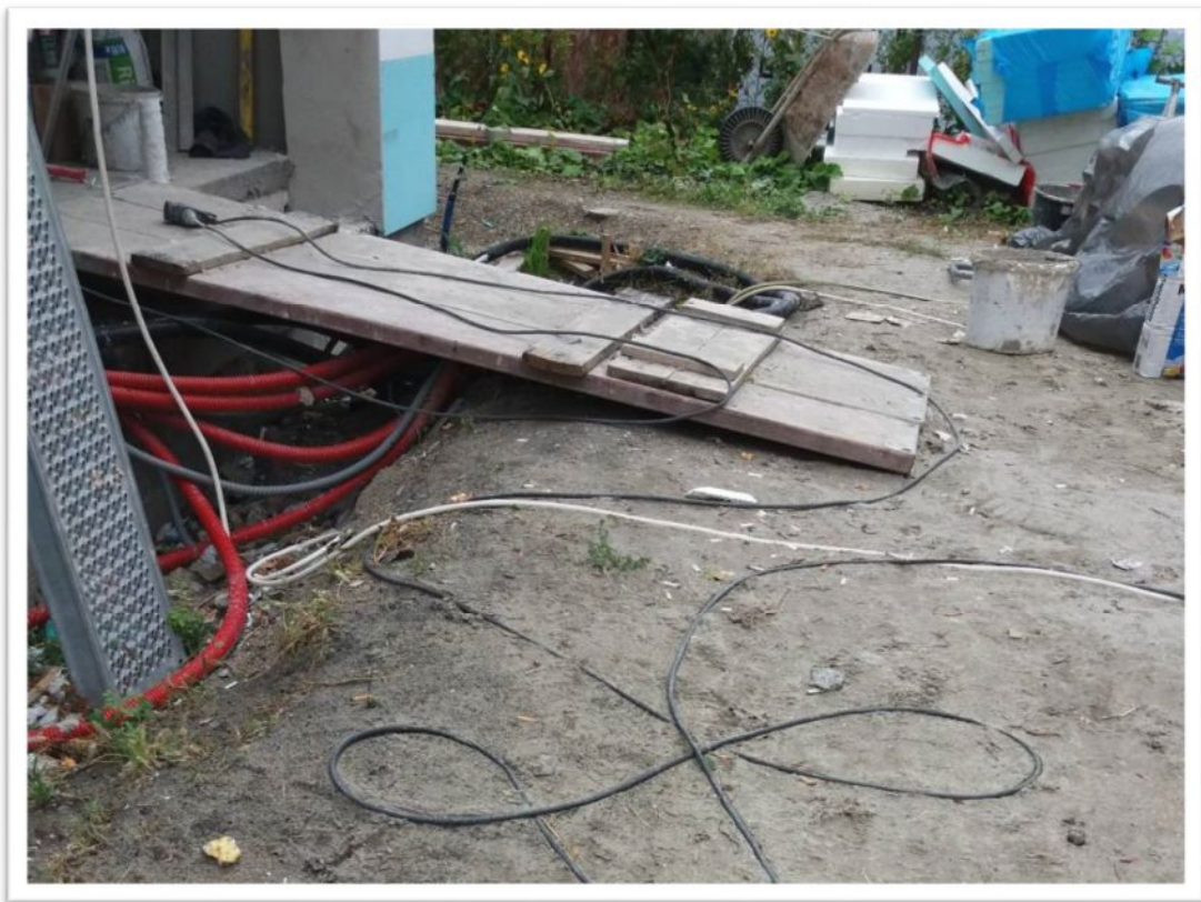
Mechanikai sérülések ellen nem védett, botlásveszélyesen kialakított villamos vezetékek
