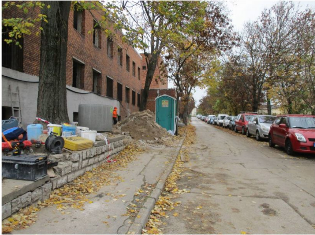
Építési terület körülkerítésének hiánya
