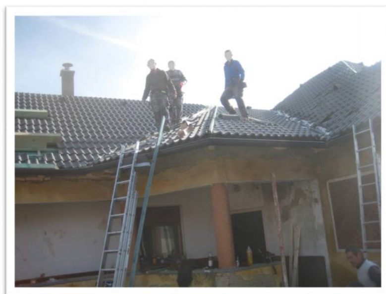
Magasban végzett munka leesés elleni védelem hiányában
