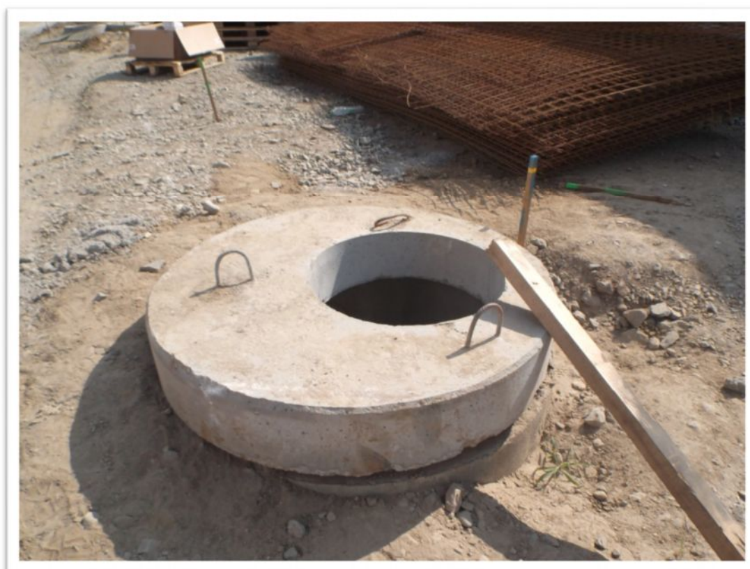
Az építési területen beesés veszélyes, jelöletlen, hiányos lefedésű csapadék-összegyűjtő akna
