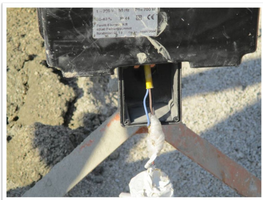
Betonkeverő gép szabálytalan kialakítású tápkábele
