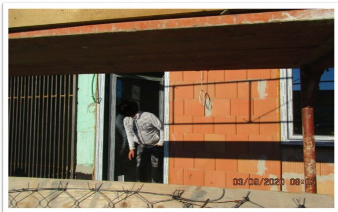
Építési területen egyéni védőeszköz hiánya (fejvédő sisak)
