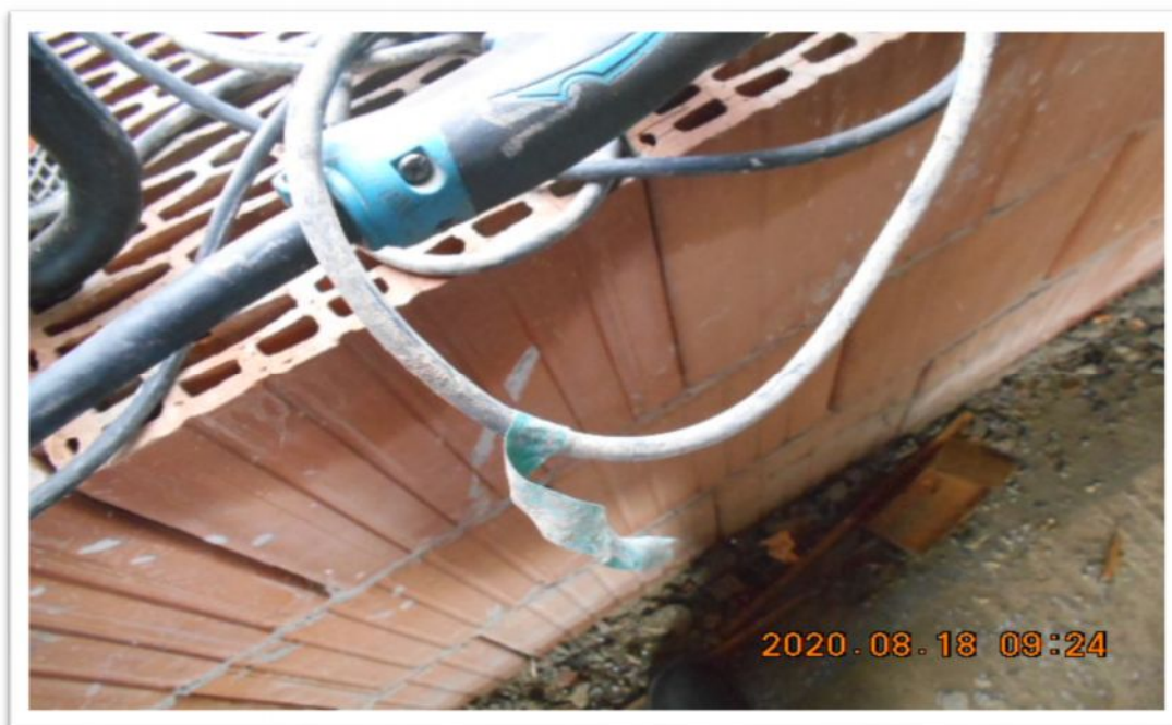
A kéziszerszám villamos vezetékén a köpenyszigetelését szigetelőszalaggal javították.
